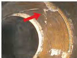
Riss im Anschluss
